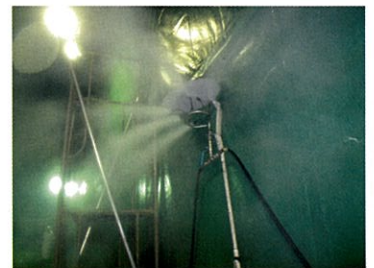
■超微細噴霧装置 (建屋内ふん塵抑制)
